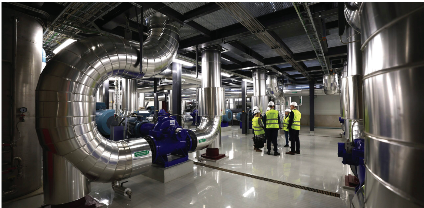
Utilitase Vao energiakompleksis avati soojuspumbajaam, mis võimaldab oluliselt vähendada maagaasi kasutamist Tallinna kaugküttevõrgus.
