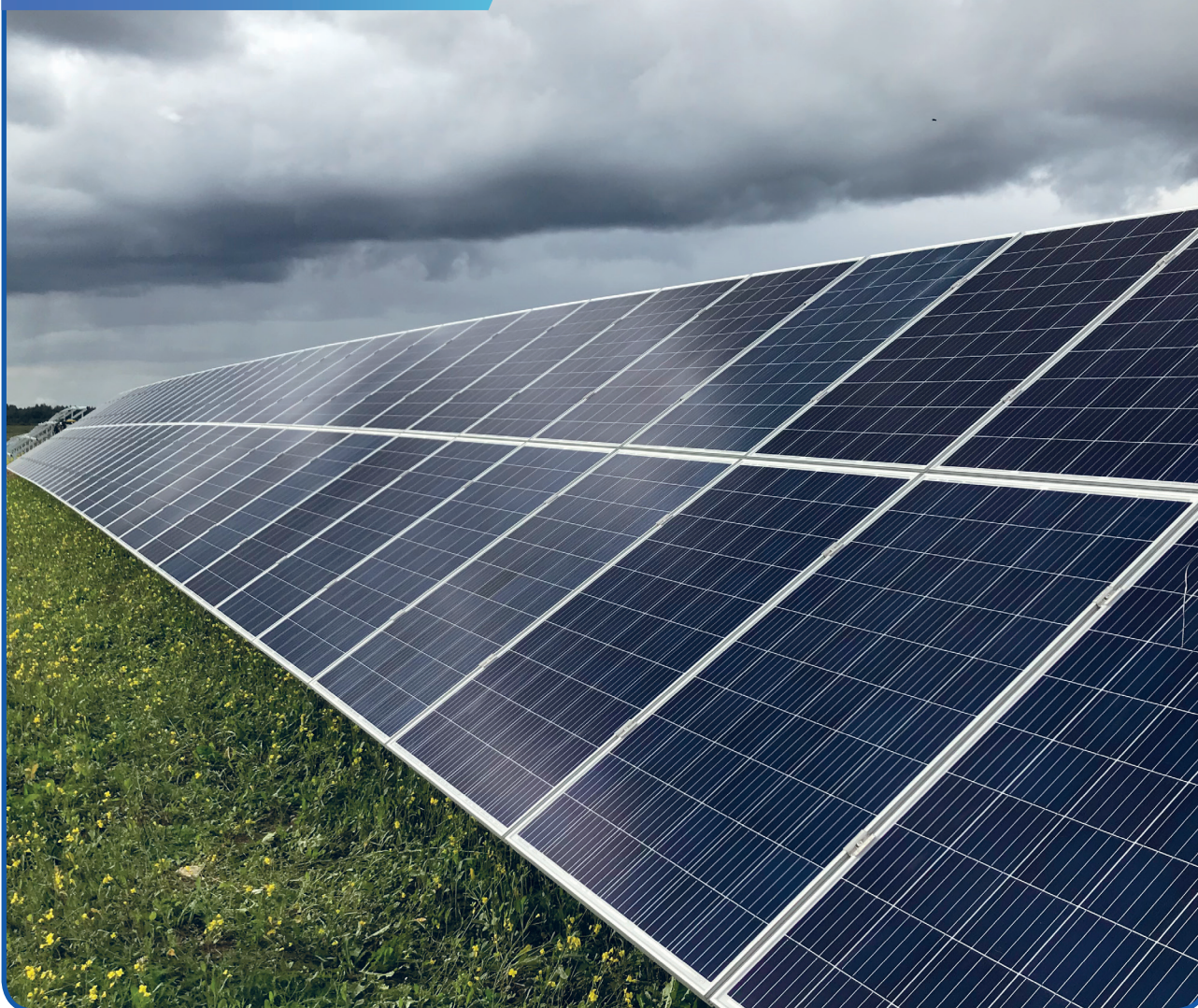
600 kW võimsusega päikeseelektrijaam Mäos
